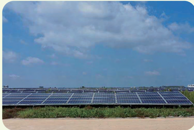
▲ 方山縣光伏電站項目
